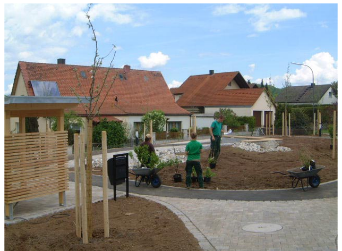
Fotos aus der Bauphase im Frühjahr 2012: (Oben) Die Trockenmauer für die Hochbeete entsteht. Wegebau / ein Geländer wird eingebaut
